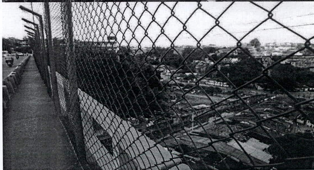
Tela de prevenção ao suicídio instalado na Ponte do Reginaldo em Maceió – AL.
